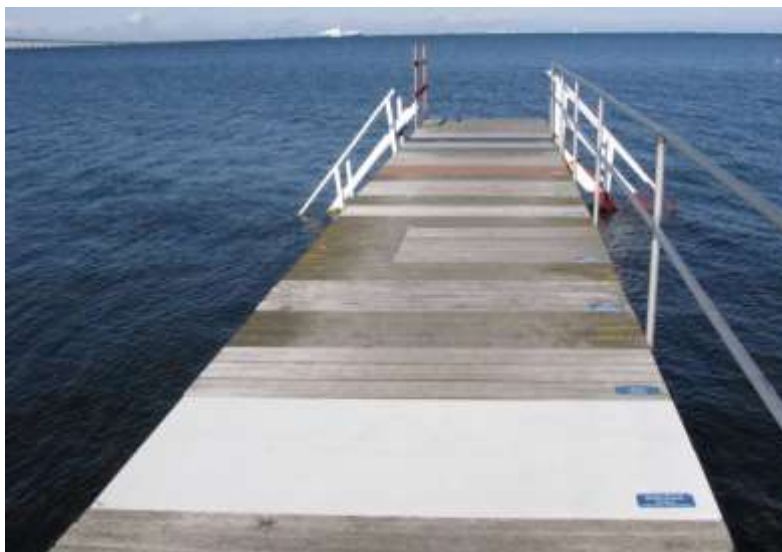
Figur 6. Brygga J, 2016-09-21, kompletterad med ett nytt material (vita skivan) som installerades under våren 2016.
