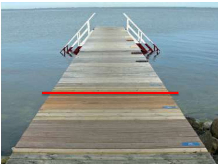
Figur 2. Brygga K, 2014-06-10, kompletterad med flera trämaterial som installerades 2014-03-14 (under det röda strecket).
