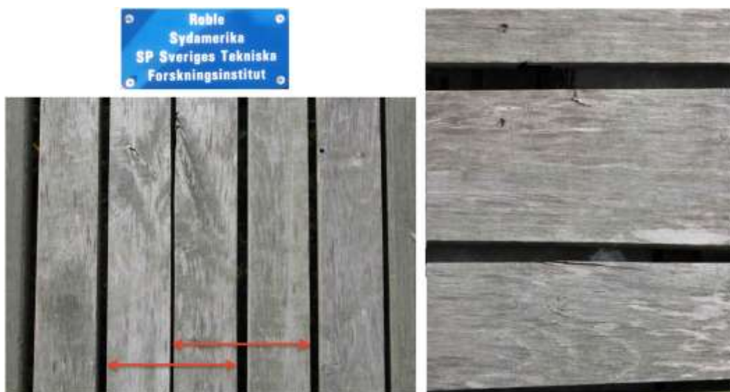
Figur 22. Utseende av robble vid det senaste inspektionstillfället. Observera tecken på dålig dimensionsstabilitet (röda pilar). Viss förekomst av uppfläkning och utstående stickor (till höger). Begynnande röta upptäcktes i skruvhål.
